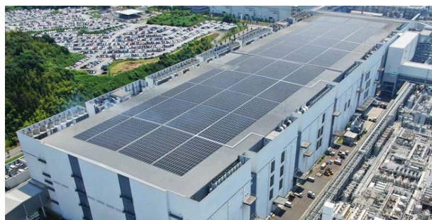
キオクシア株式会社四日市工場の太陽光発電システム（第5製造棟）
