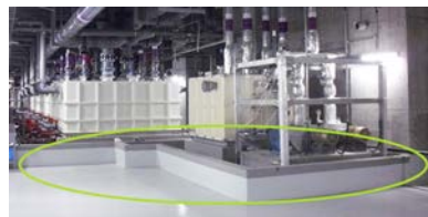
防液堤 地下・公共水域への流出防止
