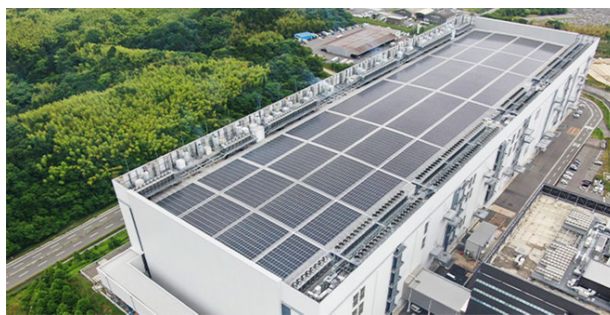
キオクシア株式会社四日市工場の太陽光発電システム（第6製造棟）
