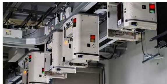
クリーンルーム内搬送装置
