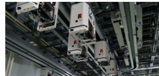
天井走行式無人搬送車 (OHT: Overhead Hoist Transport)
