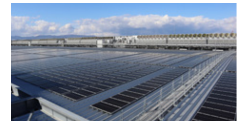
北上工場第1製造棟の太陽光発電システム
