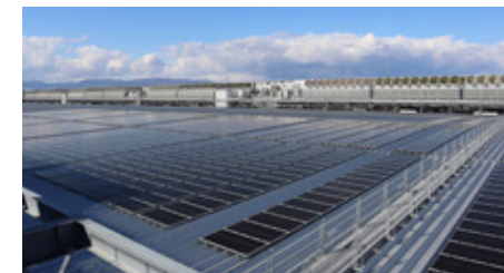
北上工場第1製造棟の太陽光発電システム
