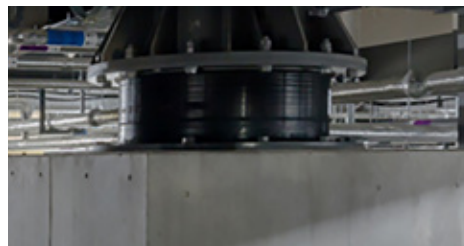
工場の免震装置
